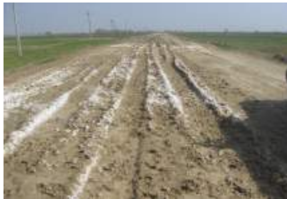
69-rasm. Yo'l poyi yuzasidagi tuzlarni ko'rinishi.
